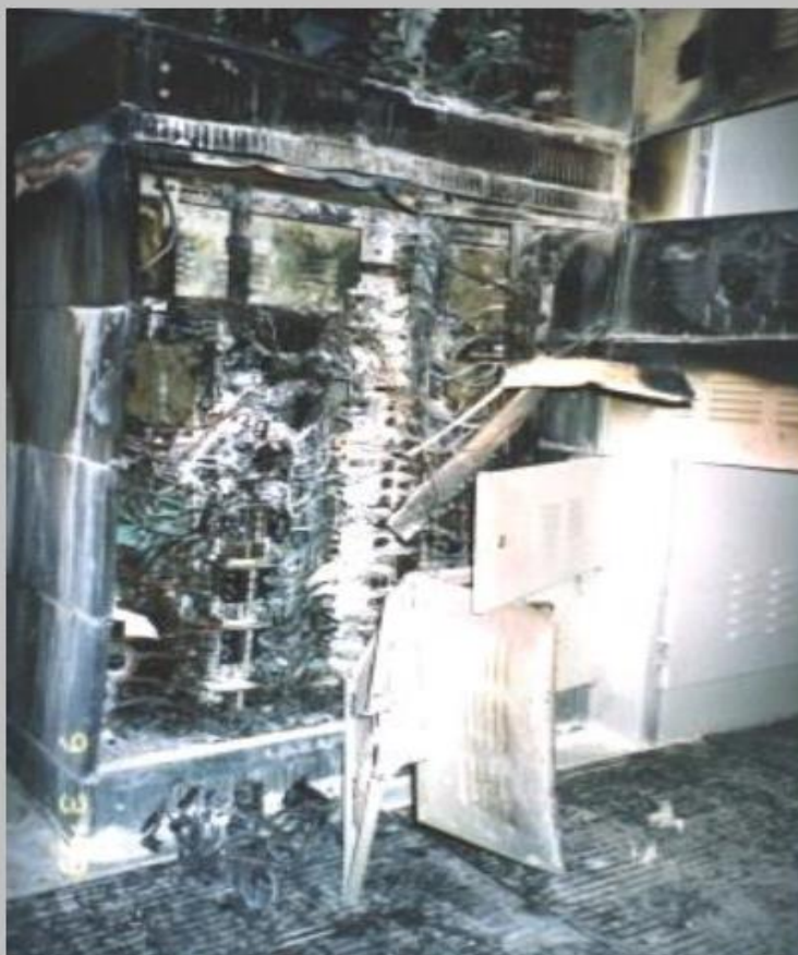
Rozdzielnia 3x400V 100 kVAr
